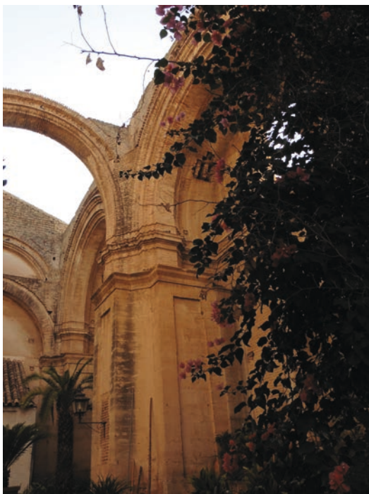
Fig. 2. Vista de los pilares originales de la iglesia de Santa Cruz y de los suplementos ideados por Ignacio Tomás para la misma. Fotografía del autor.
